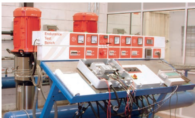
Banco hidráulico propio equipado con 7 bombas
